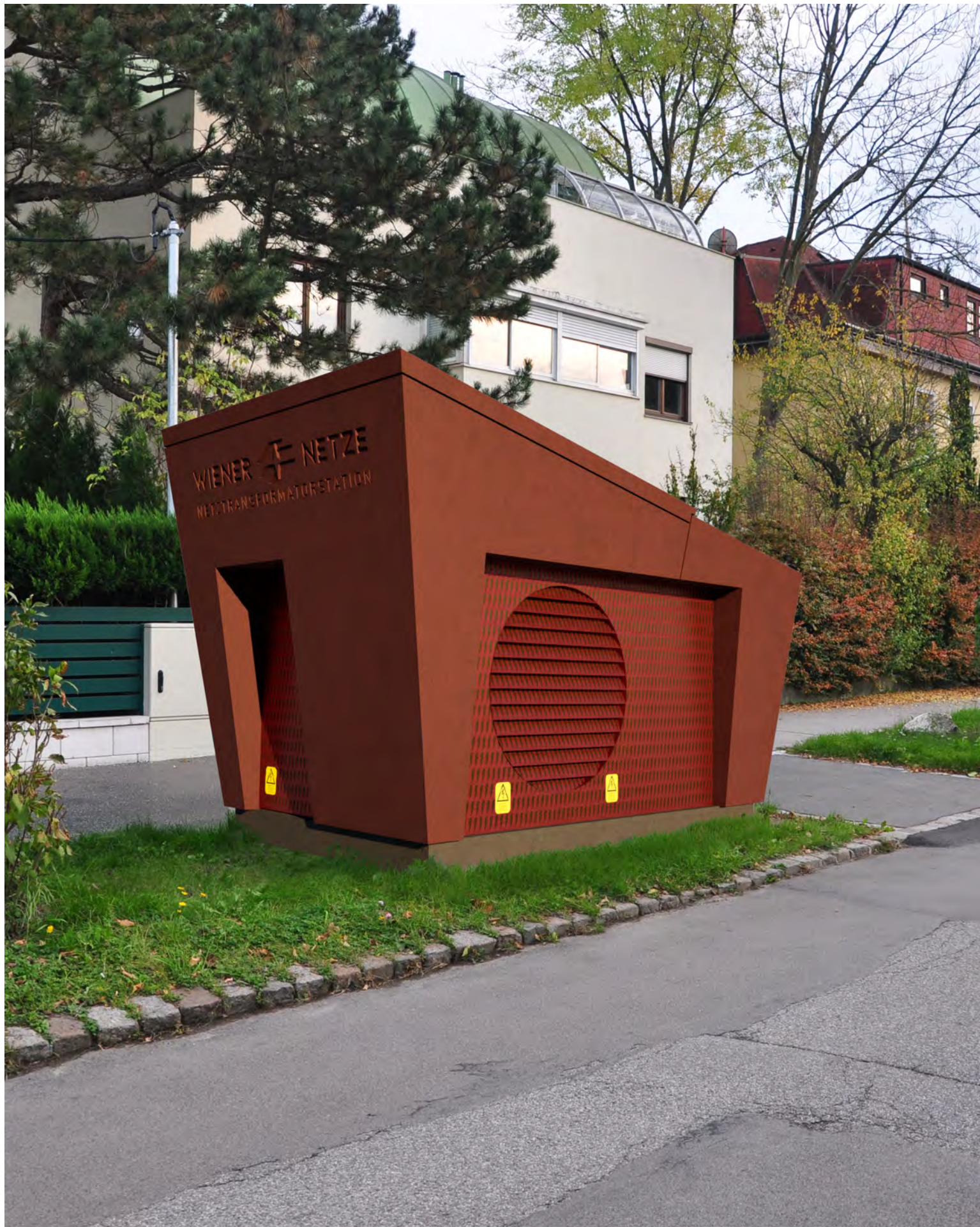
Im Wohngebiet: der Trafo ist durch seine auffällige Farbe präsent
