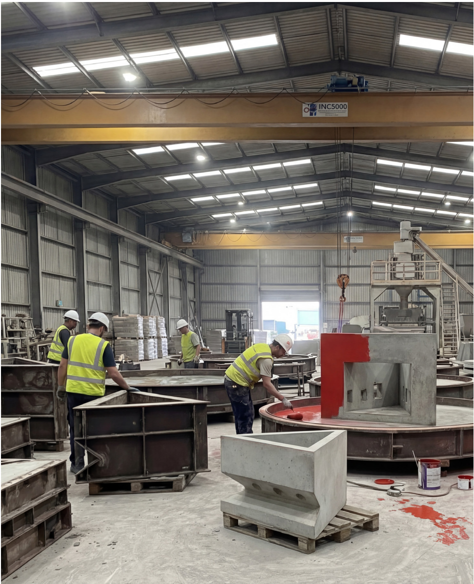
Trafostation in der Betonvorfabrikation Fundament und Funktionskern
